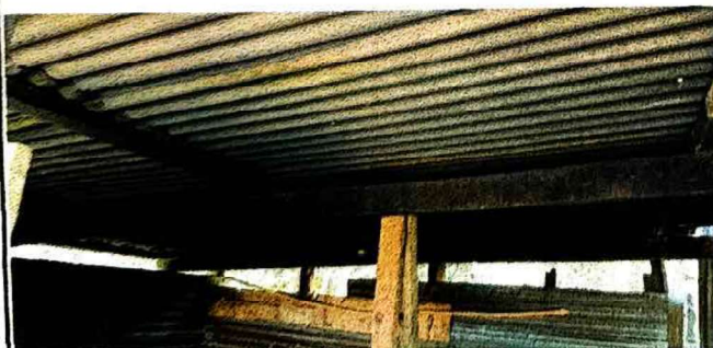
Foto 5: TECHO DE LA COCINA
